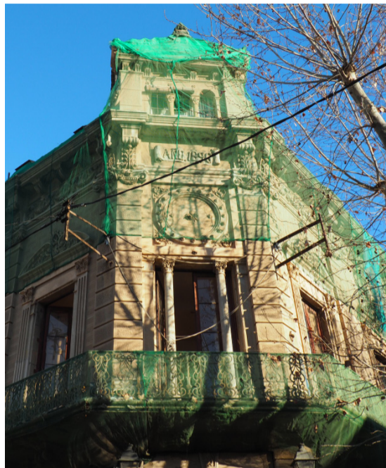
La façana de la Flor també està degradada. MARINA RIERA
